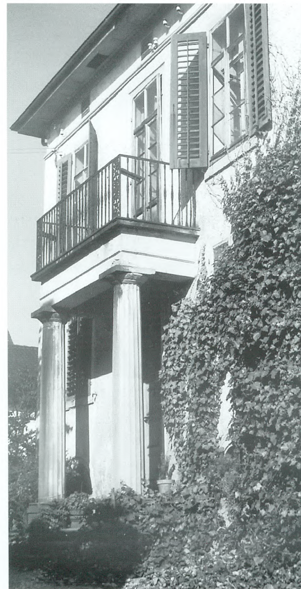
Der «Villa Berta» wurde – im wahrsten Sinn des Wortes – der Boden unter den Füßen weggezogen (get).
