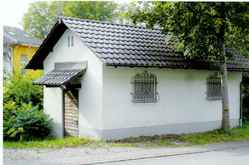
In diesem Gebäude beim Illnauer Rössli-Kreisel war bis 1997 die Messstation und ein Transformator des EWI untergebracht.
